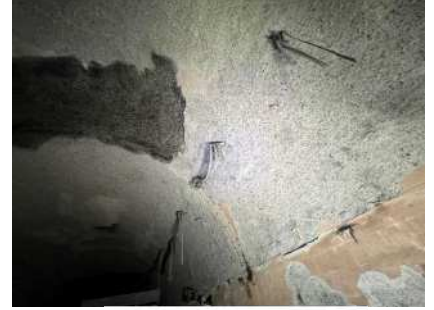
トンネル側面の剥離
