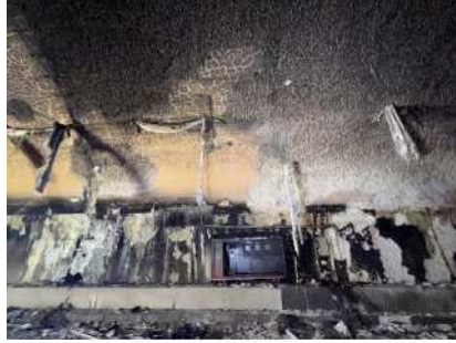
火災後のコンクリート表面
